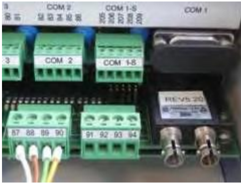
Оптоволоконный разъем (1 x Ethernet-ST, XW93) на уровне II; порты Com регулятора REG-DA на уровне III
